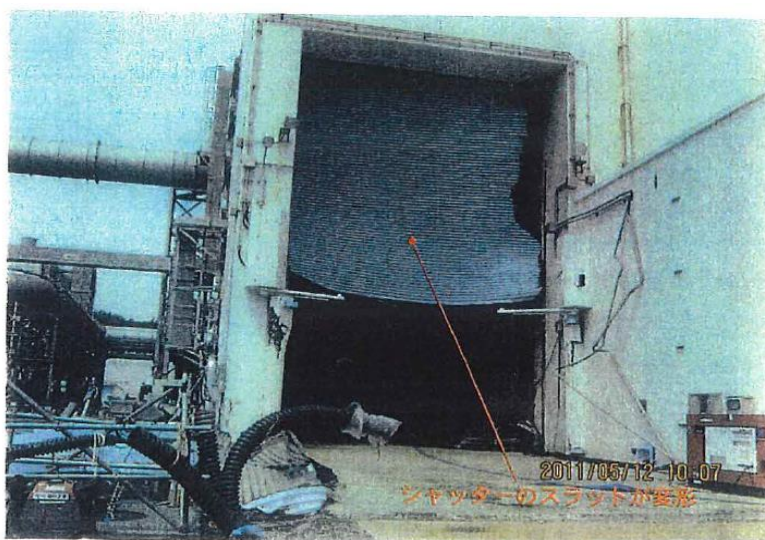
第4.1.2-13 図 建屋地上開口の状況 (4号機タービン建屋東側 大物搬入口 平成23年5月12日撮影)
